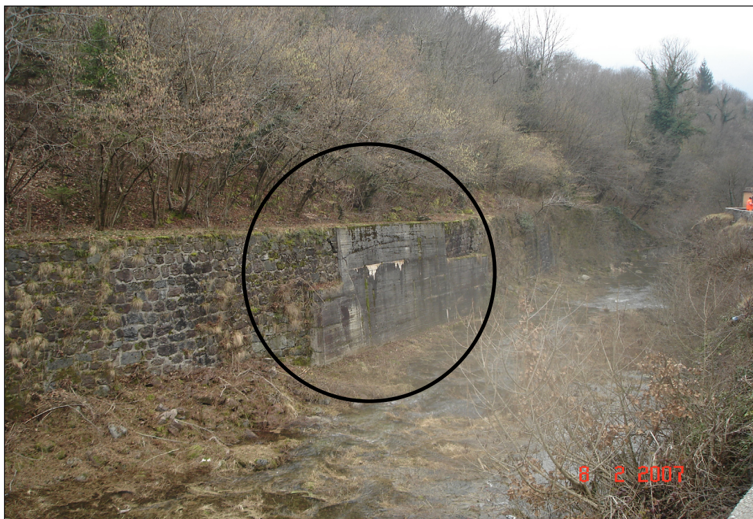
Foto 1. Rifacimento parziale d'argine a riprova di crolli passati.
